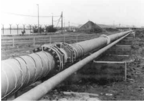
Рис. 2.18. Парафинопровод на нефтеперерабатывающем заводе
